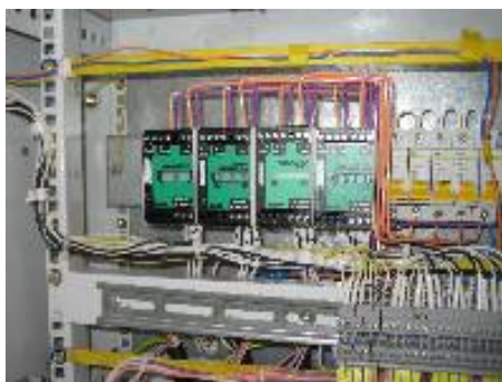
Питание расходомеров обеспечено с помощью блоков ЭМИС-БРИЗ 10, установленных в диспетчерской. Блоки ЭМИС-БРИЗ 10 используются также для преобразования частотного сигнала в аналоговый 4-20 мА с целью интеграции датчиков расхода в АСУТП
