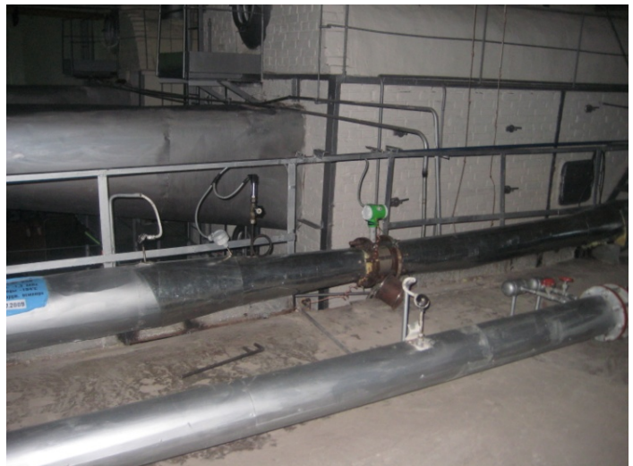
Узел учета пара на базе расходомера ЭМИС-ВИХРЬ 200 обеспечивает более высокую точность измерений и не требует обслуживания в сравнении с узлом, основанным на методе перепада давления, расположенным на соседнем трубопроводе.
