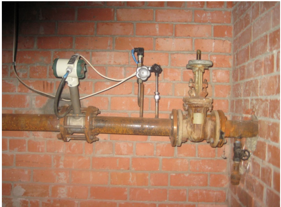
Приборы учета тепла: вихревой расходомер ЭМИС-ВИХРЬ 200, датчики АИР и ТС, установленные на ООО «Вахрушевский механический завод»
