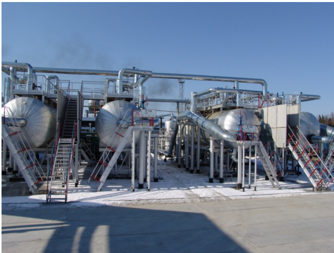
На этой нефтебазе установлены расходомеры ЭМИС
