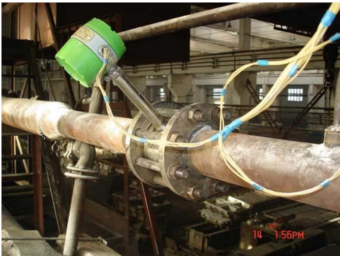
Измерение расхода пара к пропарочным полигонам железобетонных изделий с помощью расходомера «ЭМИС-ВИХРЬ 200»
