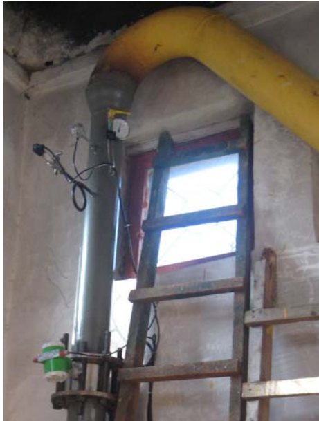
Вихревой расходомер ЭМИС-ВИХРЬ 200 ДУ 100, установленный совместно с датчиками давления и температуры
